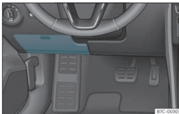
Bild 43 Vänsterstyrd fordon: säkringsboxkåpa under instrumentbrädan på förarsidan
